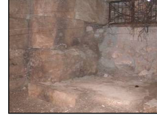
2. Ana Mekan. Güneybatı Niş. Tahrip Edilmiş Zemin
