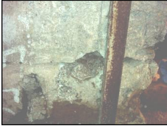
3. Ana Mekana Giriş Kapısı. Sol Sövedeki Tahribatlar
