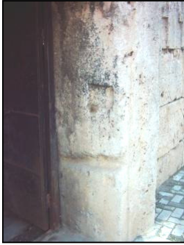
3. Ana Giriş Kapısı. Sağ Söve
