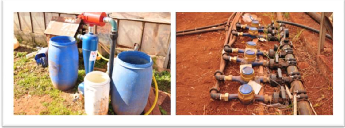
Şekil 3.3. Damla sulama sisteminde kontrol birimi
