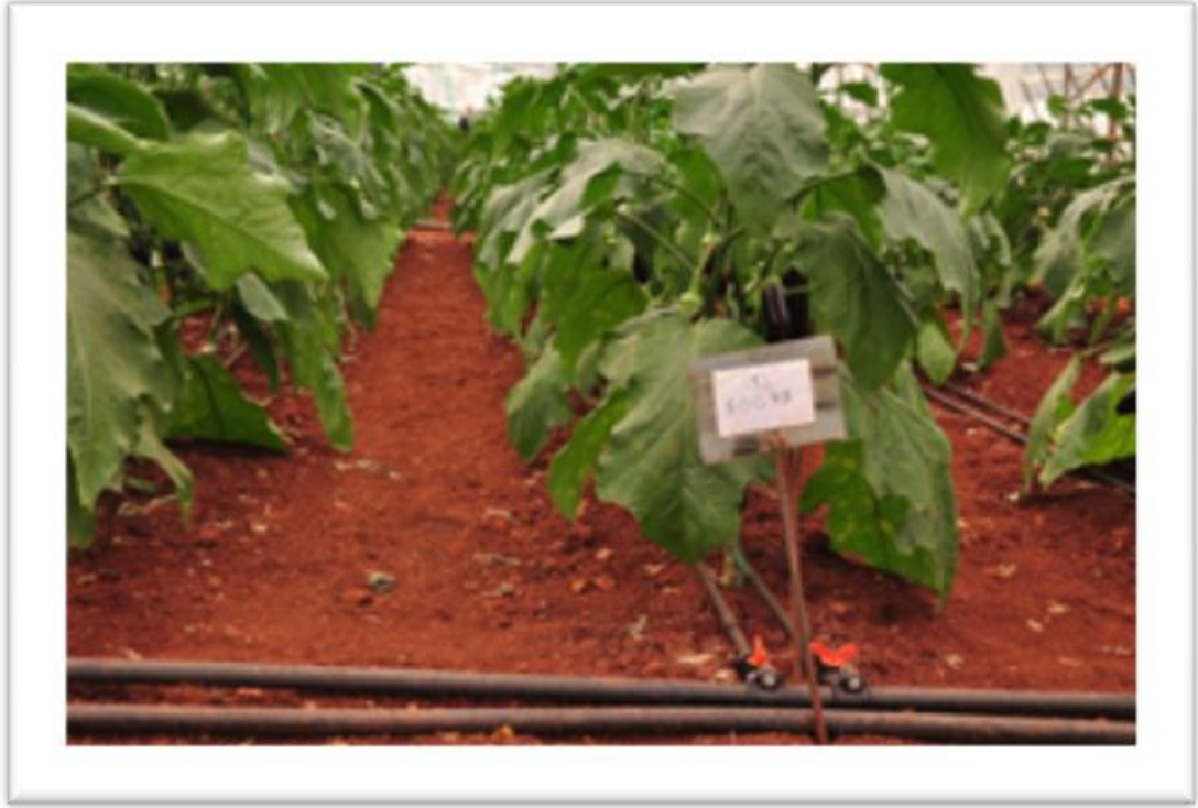
Şekil 3.4. PVC malzemeden yapılmış damla sulama boruları ve kelebek vanalar
