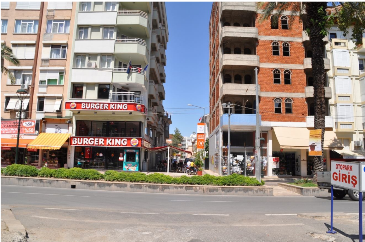
Fotoğraf 11- Haşimişcan Mahallesi'ne Atatürk Caddesi'nden Bir Giriş ve Onarılmakta Olan Eski Bir Apartman.
