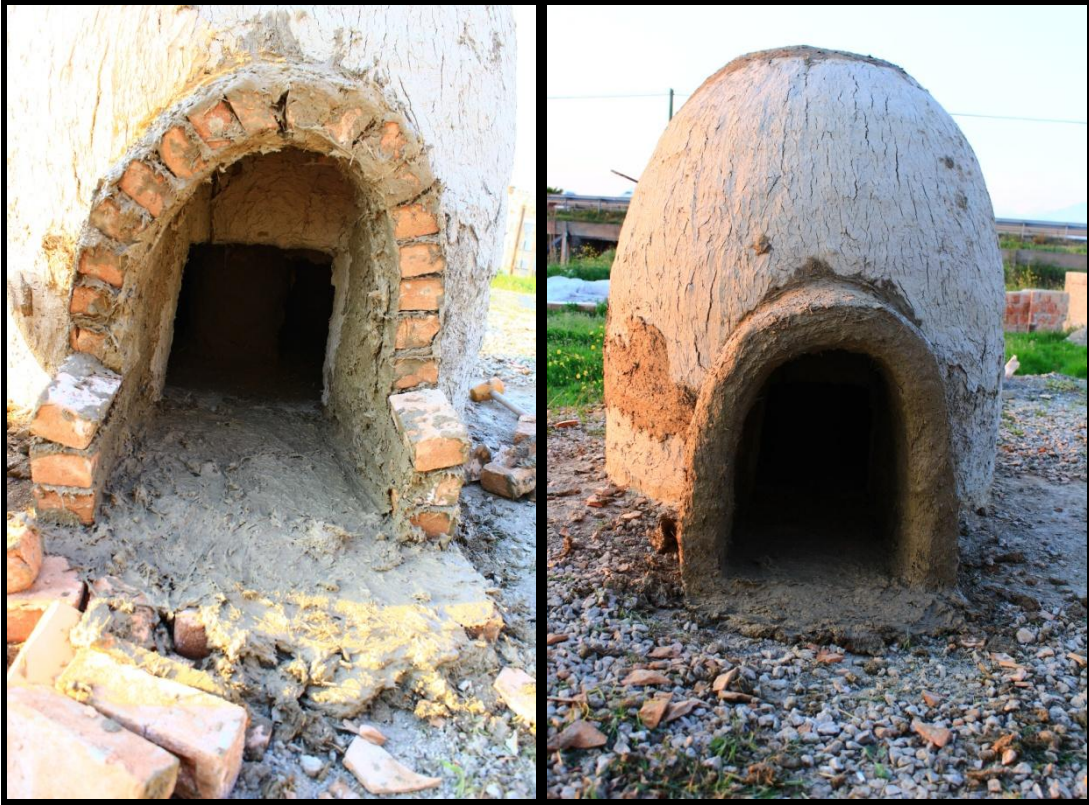
Resim 71. Fırın Ateşleme Koridorunun Yapımı.
