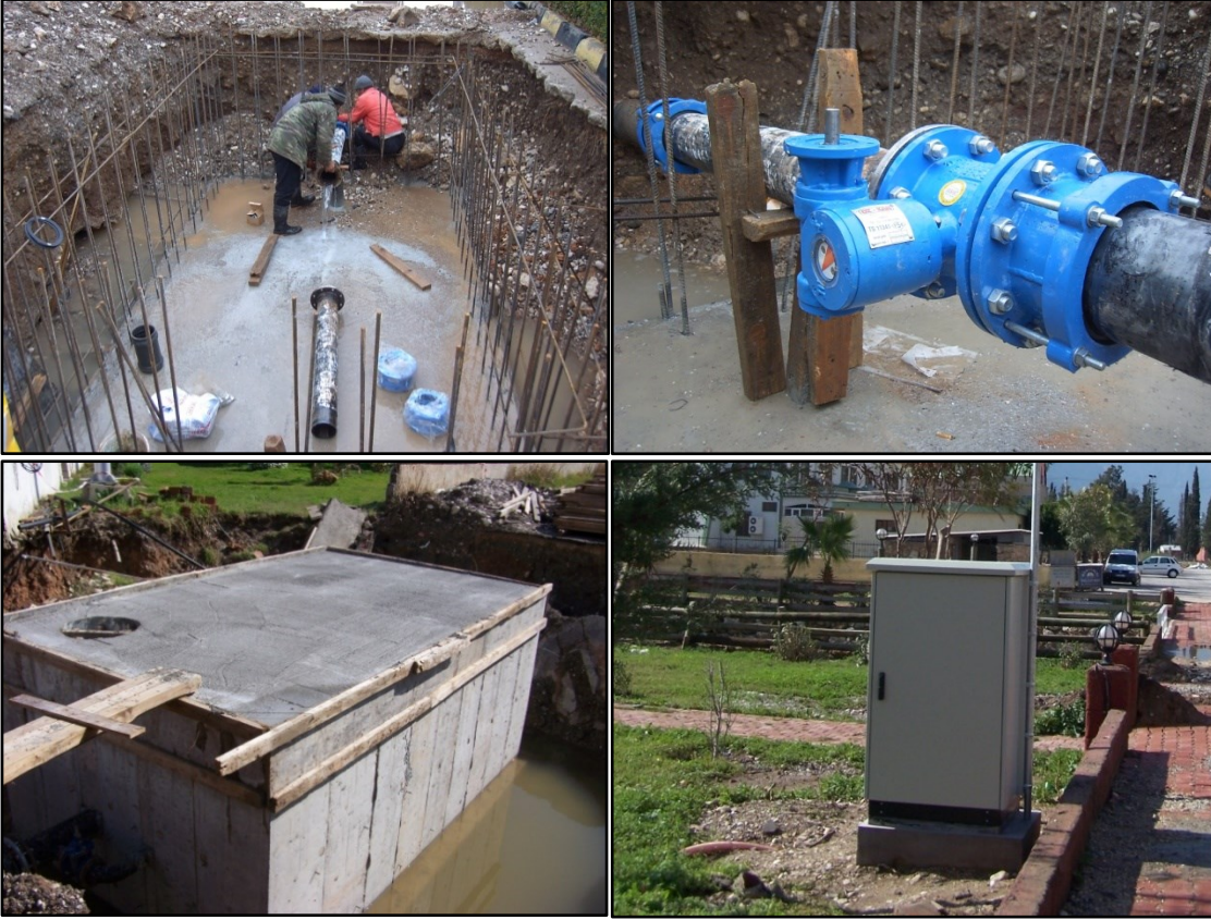
Şekil 3.4. SCADA ölçüm noktasının altyapısı (Kara vd 2016)
