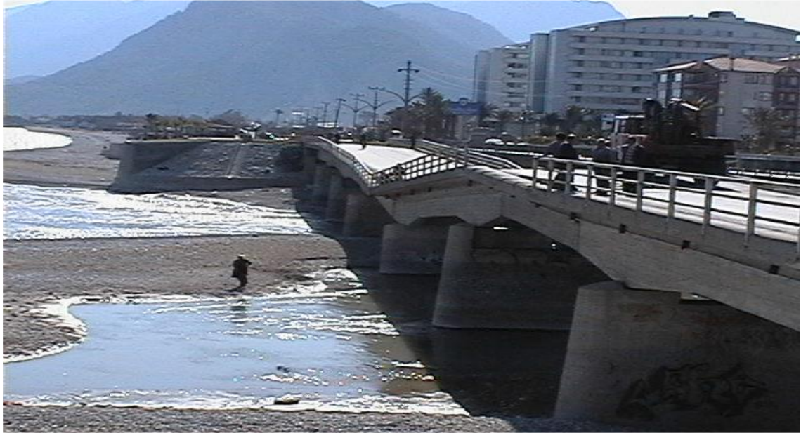
Şekil 1.1. Boğaçay köprüsü 2003 yılında felaket sonucunda hasarlı görünümü (Coşar 2010)
