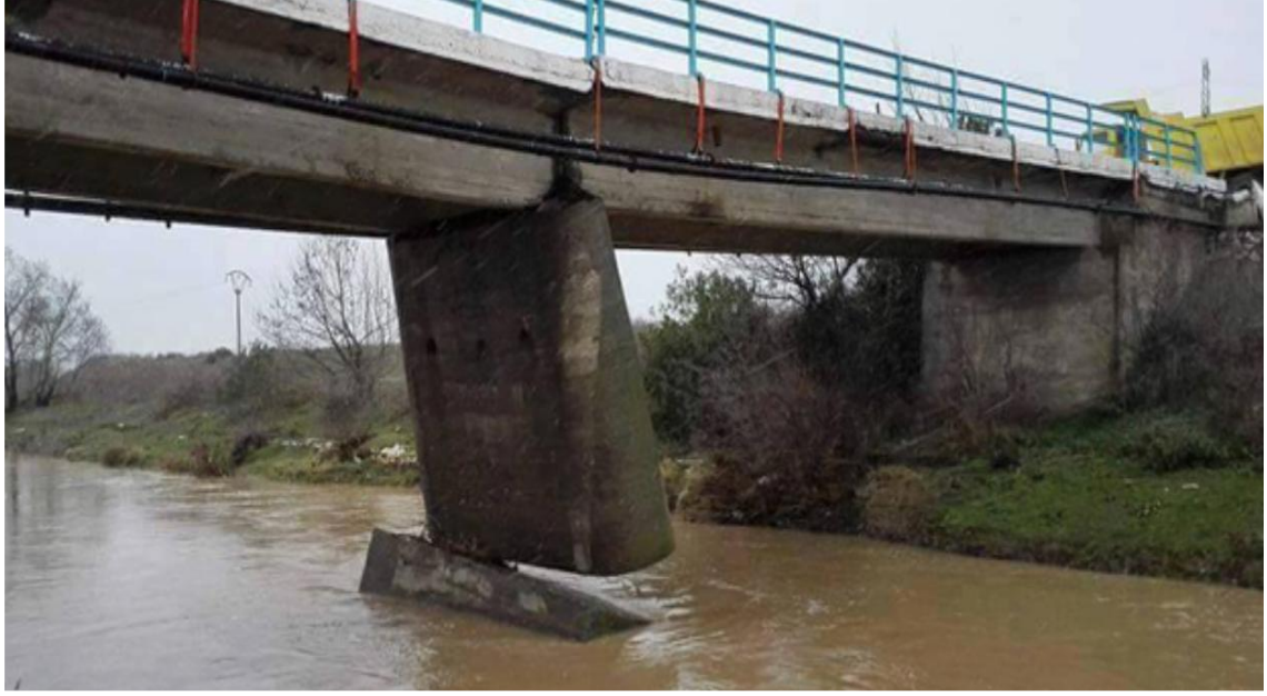
Şekil 1.2. Ocak ayında selden sonra yayakent köprü görünümü 2016 (Tuna 2016)
