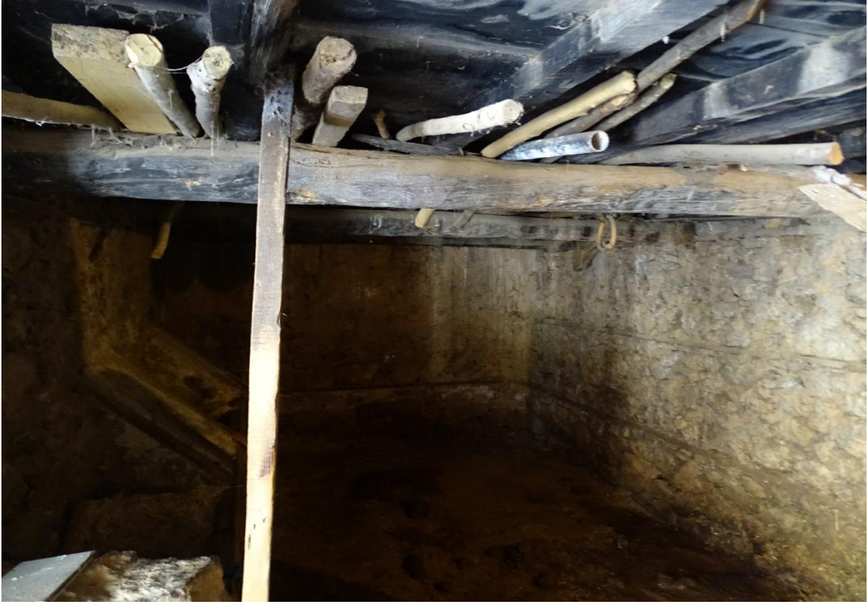
Fotoğraf 2.14 Alacami Mahallesi Meskenlerinde Ahır Örneği (17.02.2018)
