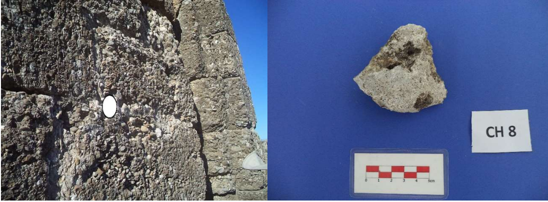
Őekil 3. 14. CH8 kodlu harç numunesi
