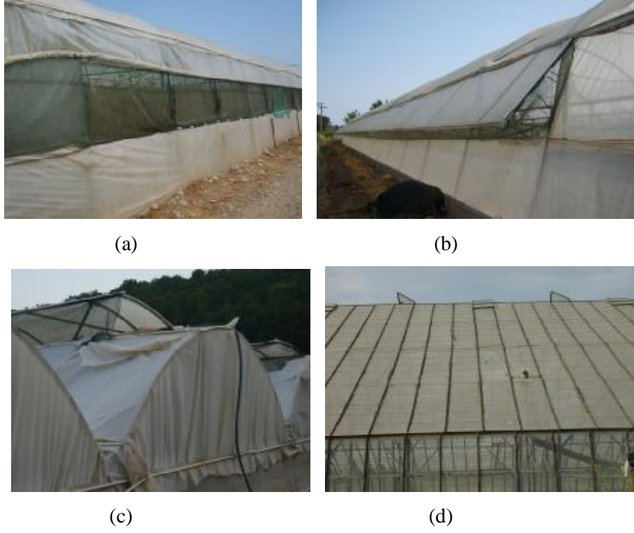
Şekil 4.8. İncelen Sera İşletmelerinde Uygulanan Havalandırma Kapaklarının Uygulanış Şekli
