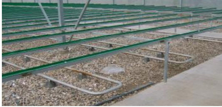
Şekil 4.10. Merkezi Isıtma Sisteminin Uygulandığı Bir Sera İşletmesi
