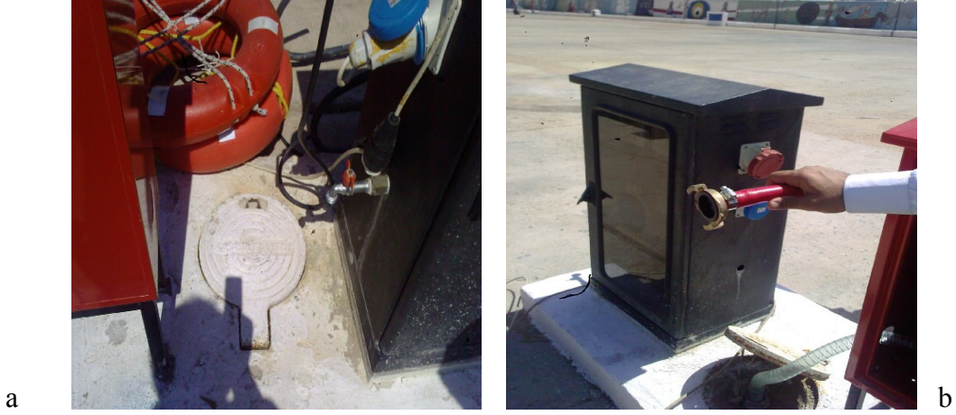
Şekil 4.32. Kaş yat limanı atıksu alım noktası
