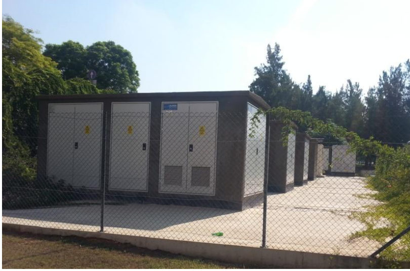
Şekil 3.1. Ölçüm Yapılan A2 Trafo Binası
