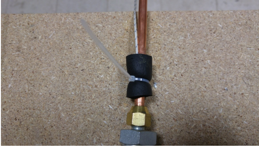
Şekil 3.15. Termokupl'un boru üzerine bağlanma şekli
