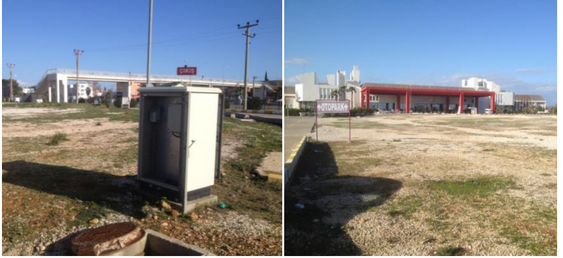
Şekil 3.13. SCADA istasyonu ve pilot uygulama için seçilen alan (Muhammetoğlu vd 2016)
