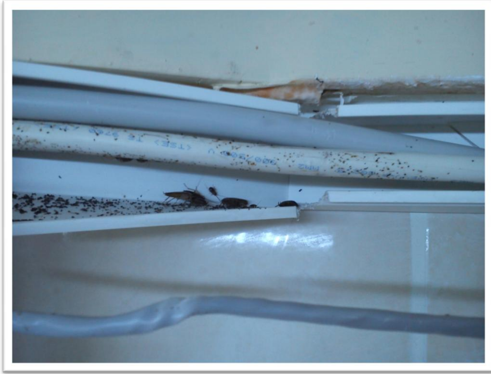
Şekil 3.7. Elektrik kablo kanallarının içinde birarada görülen B. germanica bireyleri
