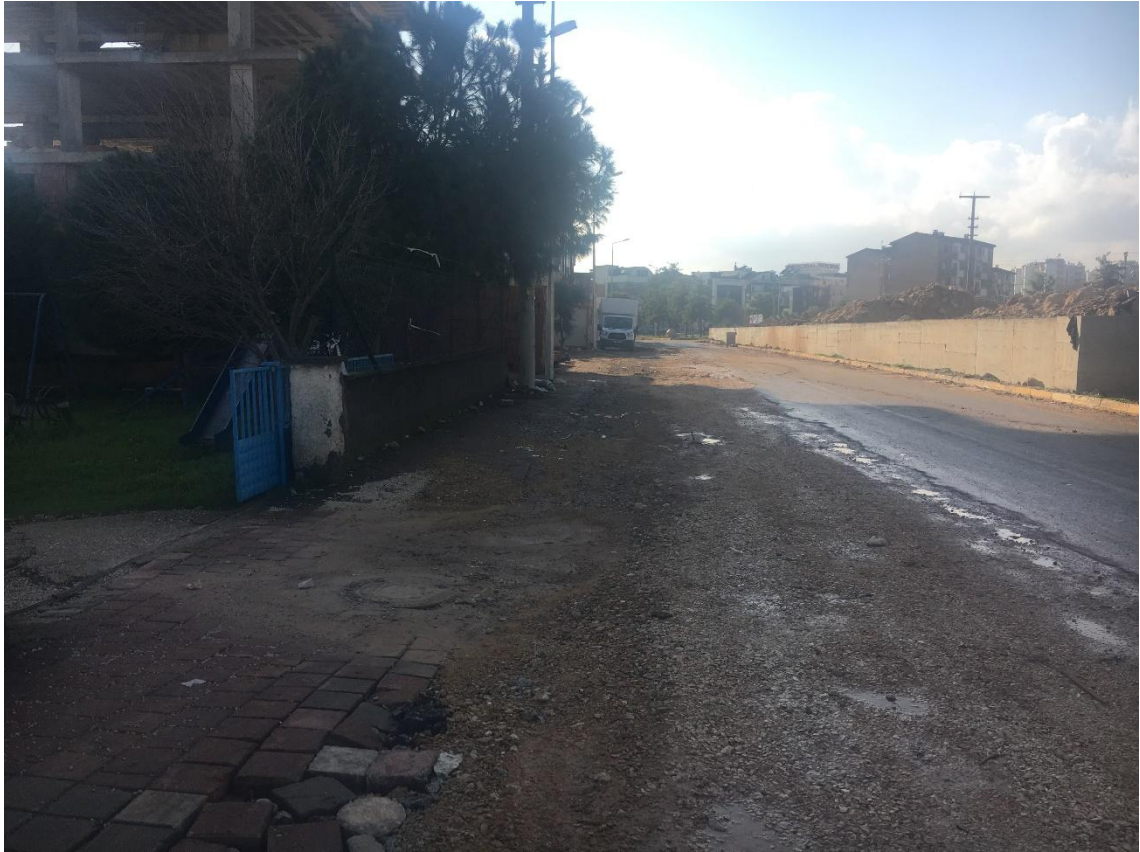
Şekil 4.5. Ceyhan Caddesi yürüyüş yolları döşemelerinin fiziksel durumu
