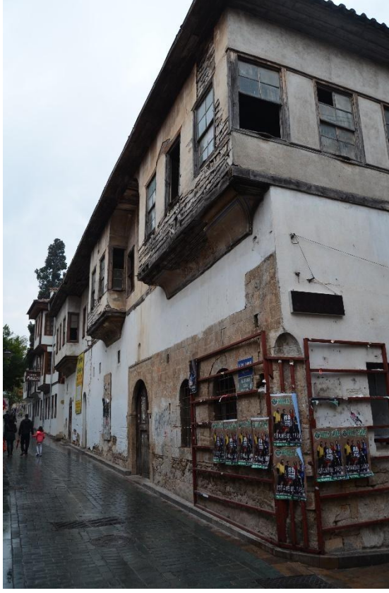
Şekil 4.17. Bakımsız ve eski bir yapı örneği (Orijinal 2018)
