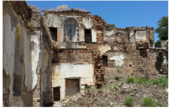
Şekil 4.16. Eski, Bakımsız ve yıkıntı halinde bir yapı örneği (Orjinal 2016)
