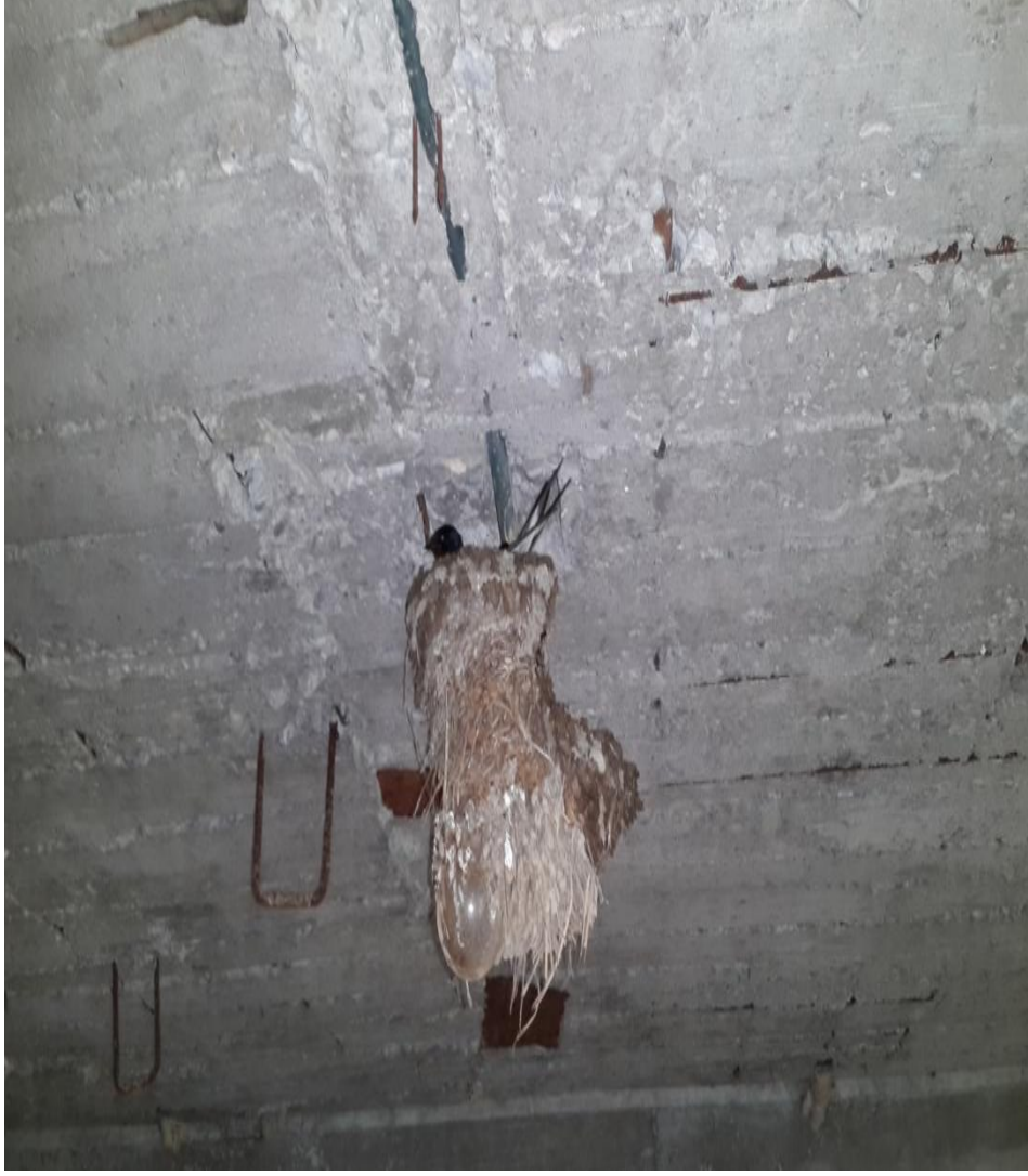
Şekil 3.1 Boğazkent Mahallesinde belirlenen bir kır kırlangıcı ( Hirundo rustica ) yuvası
