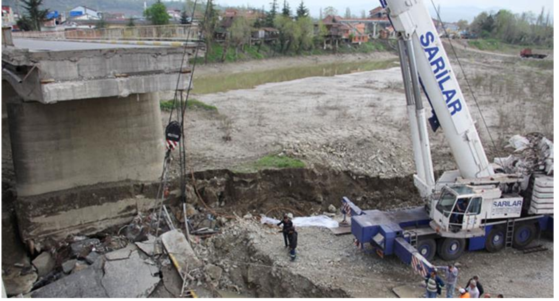
Şekil 1.1. Zonguldak'ın Çaycuma ilçesinde, Nisan ayında taşkın sonrası meydana gelen köprü faciası (Sondevir, 2012)
