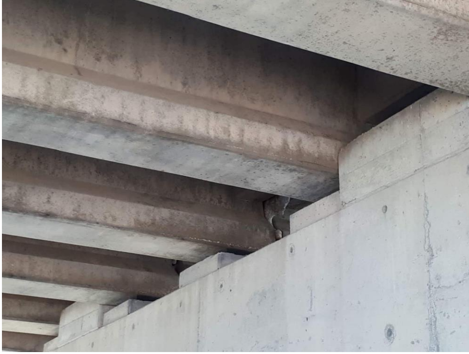
Şekil 3.10. Köprü orta ayağı üzerinde yer alan elastomer mesnetlere ait bir görünüm
