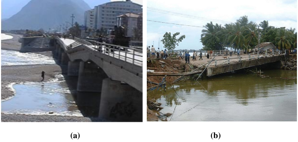
Şekil 1.3. (a) Boğaçay köprüsü 2003 yılında felaket sonucunda hasarlı görünümü (COŞAR, 2010) (b) Kenar ayak erozyonu ve oyulma nedeniyle Galle, Sri Lanka'nın güneyinde göçen Magalle Köprüsü (EEFIT, 2006)
