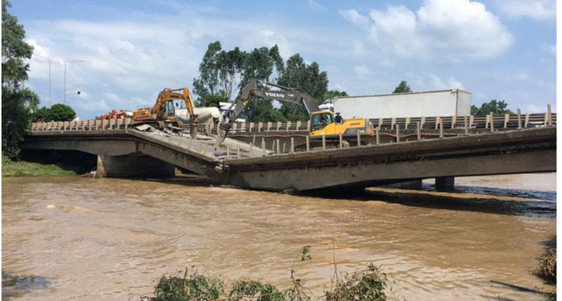
Şekil 1.2. Ordu'nun Ünye ilçesindeki Cevizdere Köprüsü taşkın sonrası (Web, 2018)
