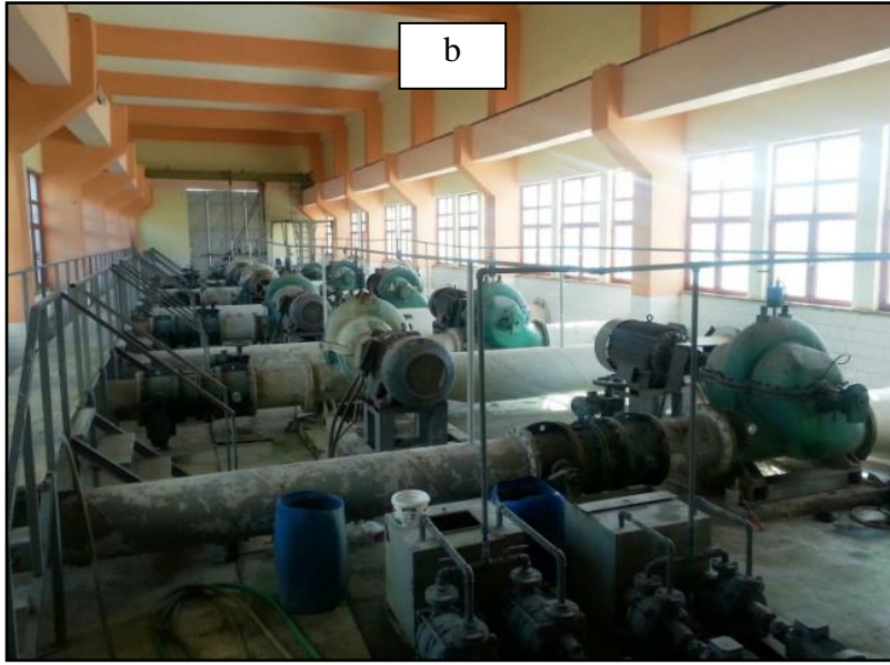
Şekil 3.7. Döşemealtı Pompaj Sulama Birliği a) Yaklaşım havuzu fotoğrafı; b) Ana bina pompa fotoğrafı
