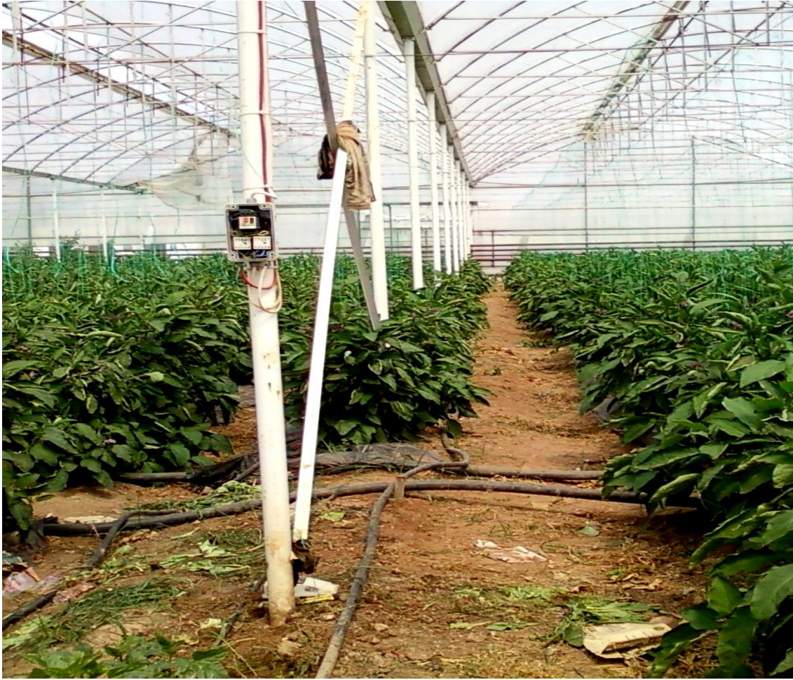
Şekil 4.17 Açıkta duran elektrik tesisatı ve yürüyüş yolu üzerindeki sulama sistemi
