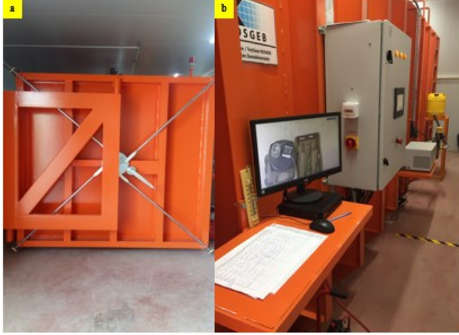
Şekil 3.3. a) Vakumla ön soğutma sistemin dış görünümü; b) kontrol paneli
